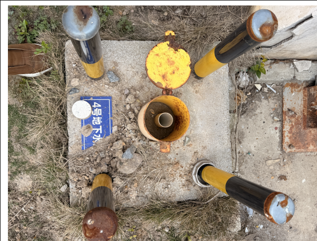
地下水观测井
